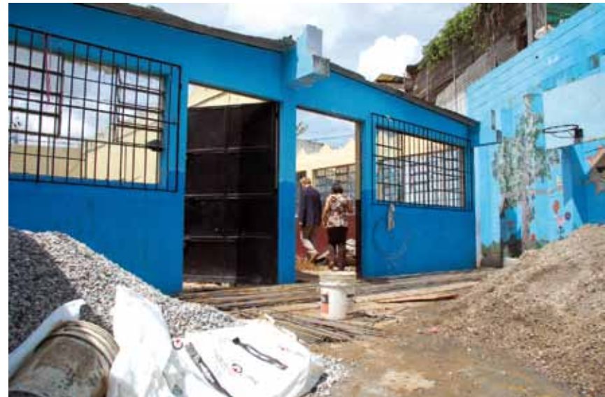
Oktober 2012: Das Dach ist ab. Bis Jahresende soll die 2. Etage der Schule entstehen. Im Februar 2013 beginnt der Unterricht - erstmals auch für Klasse 3.
